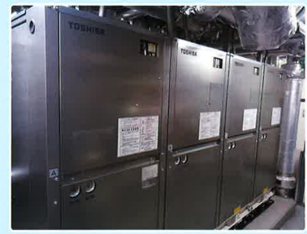
地中熱ヒートポンプ
