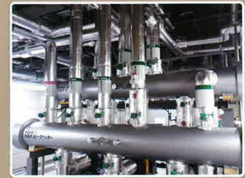
空調用熱源水配管ヘッダー
