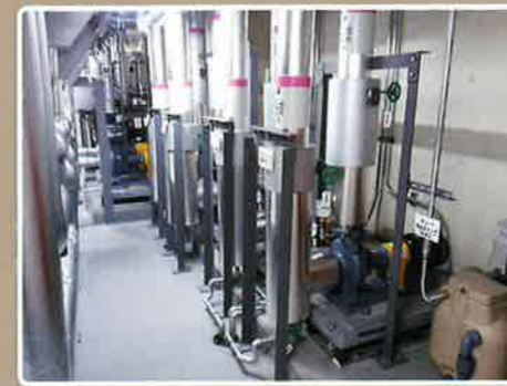
空調用熱源水ポンプ
