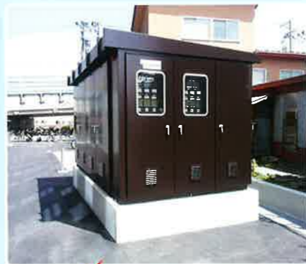
融雪用ポンプ室
