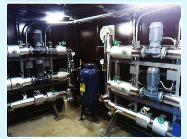
融雪用ポンプ室内配管
